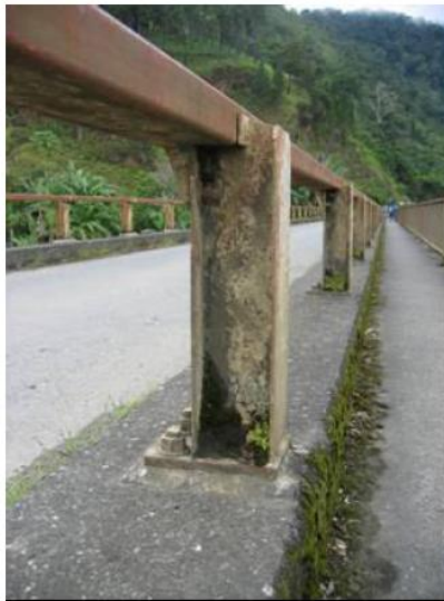
Figura 6-6 Oxidación (baranda de acero)
