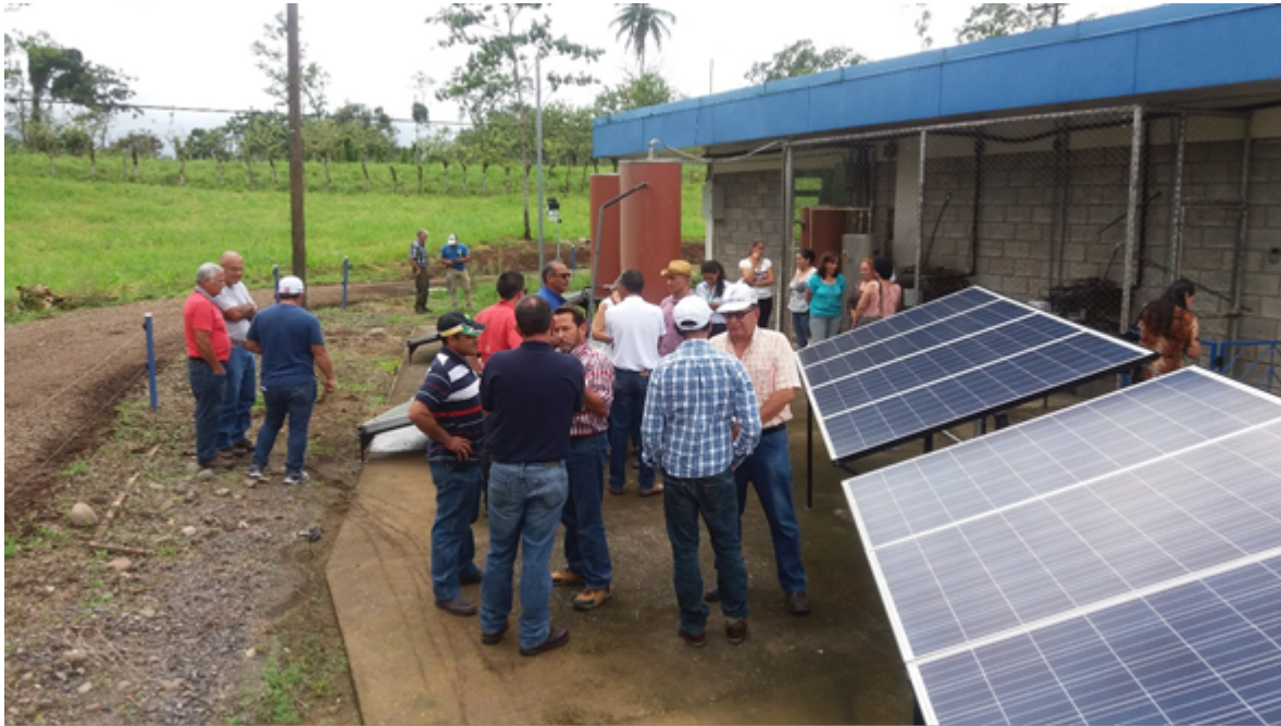
Imagen de los paneles instalados en la Sede Regional San Carlos. Foto cortesía de Cristian Moreira
