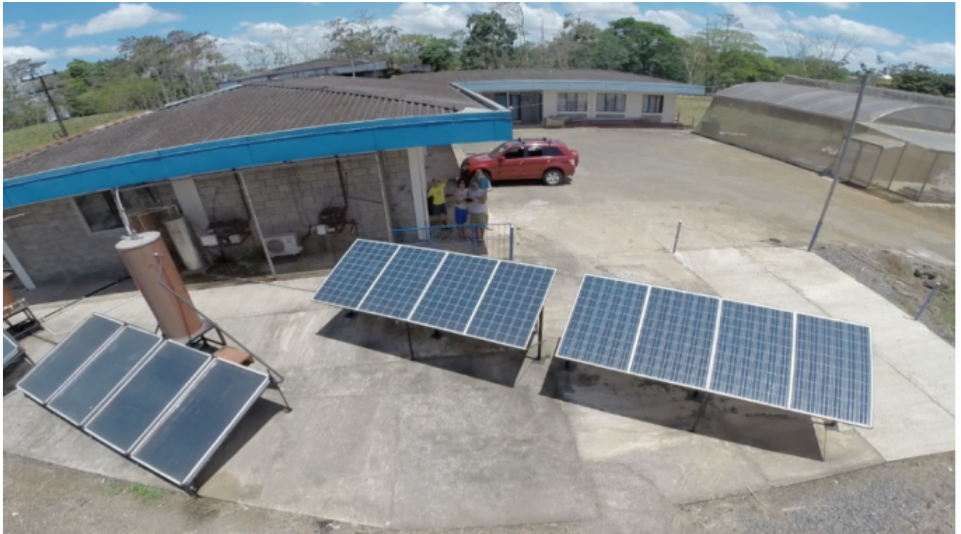
Imagen de los paneles instalados en una de las fincas. (Fotografía: Tomás Guzmán)
