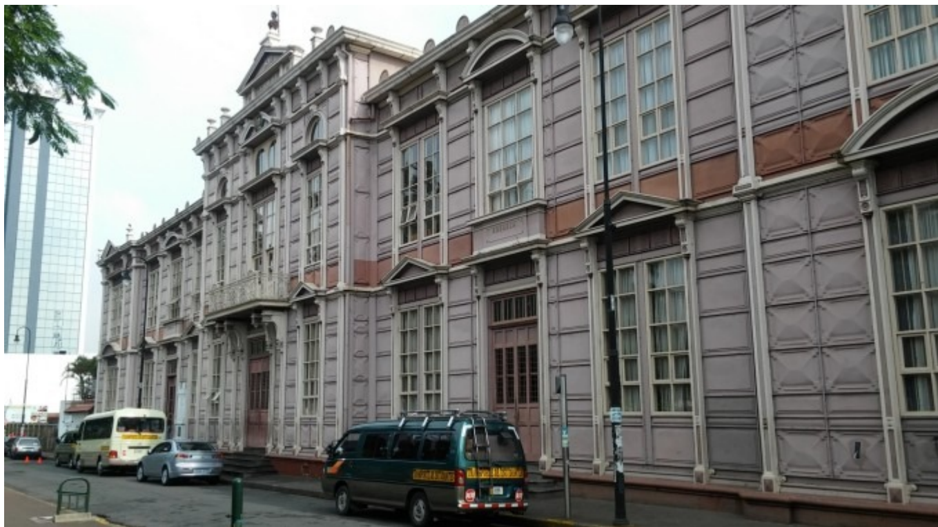
Escuela Buenaventura Corrales (Edificio Escuela Metálica), distrito El Carmen en San José. Fotografía con fines ilustrativos. (Foto cortesía de David Porras).
